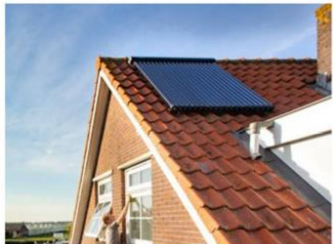
Collector zonneboiler (Bron: www.milieucentraal.nl )
