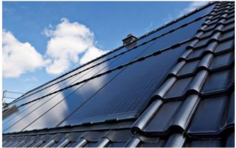
Zonnepanelen tussen dakbedekking (Bron: www.zonnepaneelprijzen.nl )
